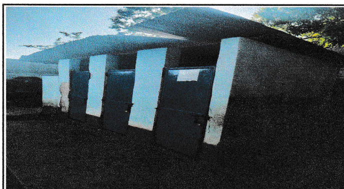
Foto 4: Cambio de lámina y estructura de metal en mal estado en baño, cocina y bodega.
