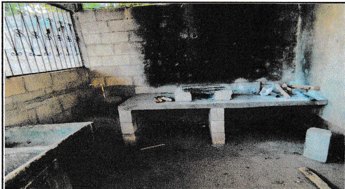
Foto 1: Cocina en mal estado, cambio de plancha y chimenea.
