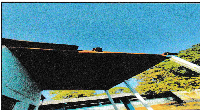
Foto 3: Lámina de cocina y bodega deteriorada.
